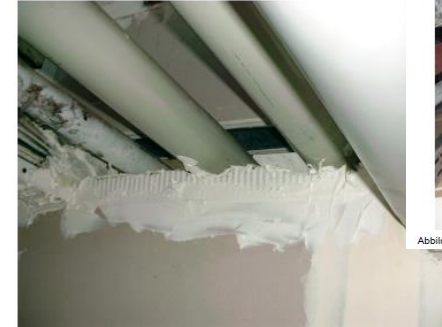
Abbildung 21: Kabel und Rohre durch F90 Trockenbauwand
